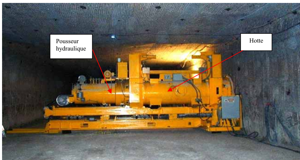
Figure 9.3.14 Hotte équipée d'un pousseur hydraulique pour la mise en place de déchets de type RH dans des alvéoles horizontales de l'installation du WIPP
