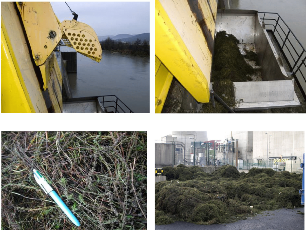
Abbildung 3.5.1: Eintrag von Wasserpflanzen in Kühlwassereinlaufbauwerke des französischen Kernkraftwerks Cruas [BERTRAND 2010]
