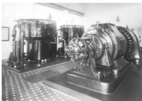
Subestación del Ferrocarril de Bilbao a Plencia en Luchana. En primer plano un grupo convertidor rotativo y tras él, dos rectificadores de vapor de mercurio.
