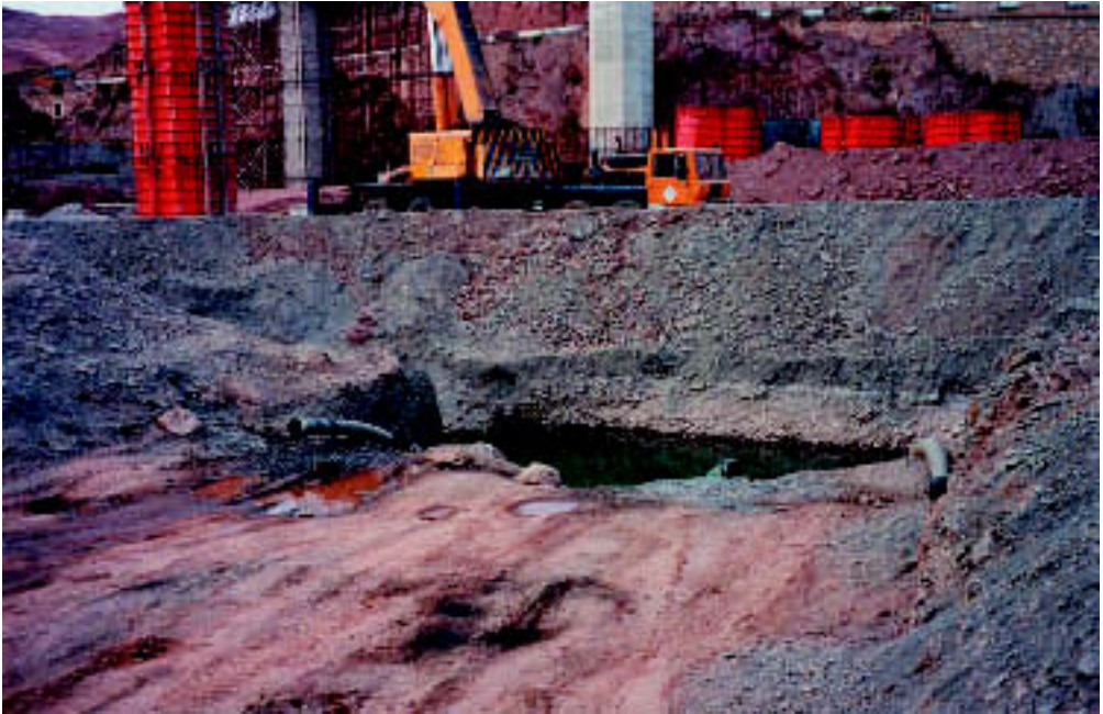
Foto 30. Afloramiento de agua en las Peñas Blancas, en cuanto se excavó para los pilotes del Viaducto.
