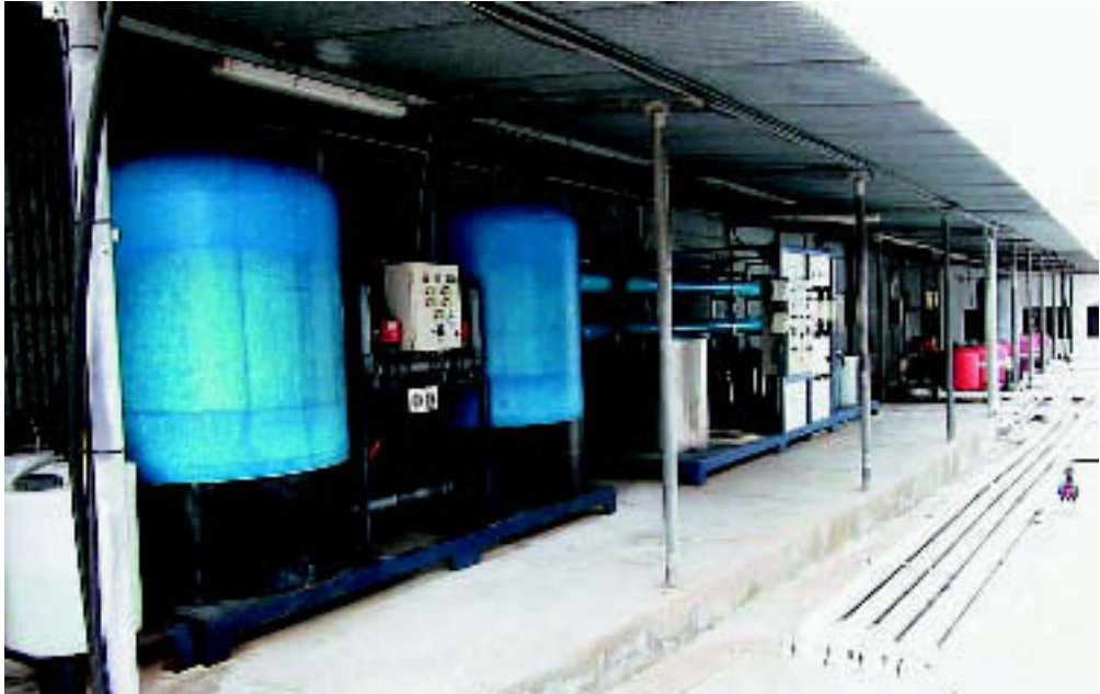
Foto 22. Planta de ósmosis inversa en Barberet & Blanc.
