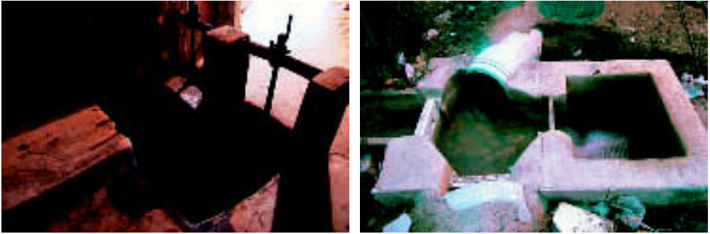
Foto 61. Partidores de aguas de la Comunidad de Propietarios de las Aguas del Caño y Balsa de Lumbreras.
