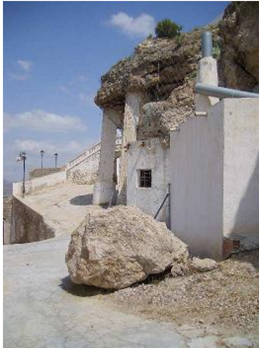
Derrumbamiento de una roca en la zona alta
