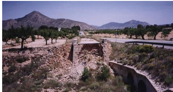
Puente destruido durante las lluvias de 1989
