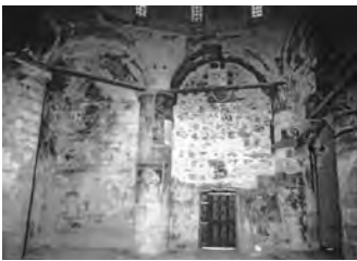
Η θέση των τοιχογραφιών του βόρειου τοίχου της Εκκλησίας του Αντιφωνητή, που αφαιρέθηκαν από τους Τούρκους μετά το 1974 (φωτ. Α. Παπαγεωργίου)
