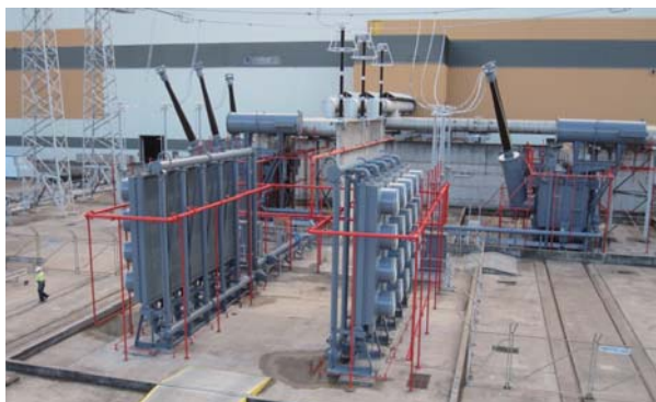
更新後の発電機用変圧器全体レイアウト Generator transformer after replacement
