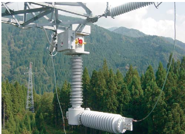
塔上開閉装置
