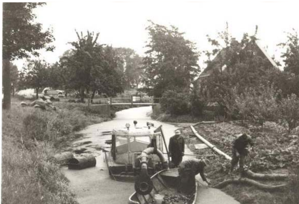
Afb. 56 Het baggeren van de Weimers langs de Oostergouw. Het baggeren voert men hier uit met een klein zuigertje (is een pomp op een ponton, die zeer vuil water kan wegpompen). De bagger wordt door de buis met water naar een stuk land in de polder afgevoerd. Vanwege de fruitbomen kon men niet met een dragline baggeren.
