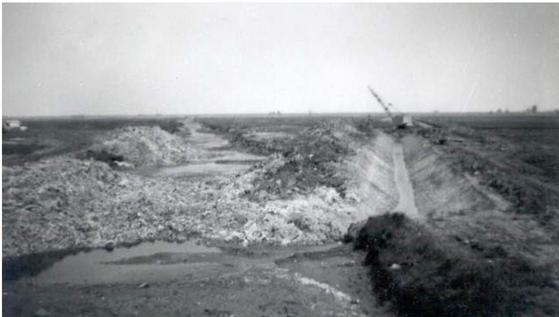
Afb. 79 Het graven van de noordelijke wegsloot van de Burgemeester Zijpweg. Op de foto is het Kerkwater nog te zien. Het is gebaggerd en ligt klaar om te worden gedempt. Aan het eind van het Kerkwater is de schoorsteen van het stoomgemaal te zien.
