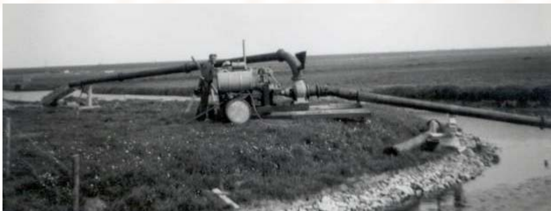
Afb. 61 Een van de vele pompen voor het verzorgen van de onderbemalingen. Deze pomp moest de Kadijk op een lager peil brengen.
