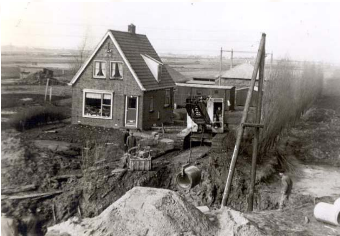
Afb. 77 Hier is men bezig met het aanbrengen van de duiker bij Zuiderdijk 31. Dit was het veeteeltbedrijf van de familie Roos. Enige tijd geleden is het woonhuis gesloopt.
