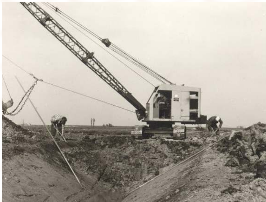
Afb. 53 Een dragline is de wegsloot aan het graven van de Bgm. Zijweg. Op de foto is de kraan van Zwagemaker bezig, terwijl twee grondwerkers de insteek aan het maken zijn. Dit was nodig om voor de machinist aan te geven waar de sloot in het maaiveld begon. Links op de achtergrond is het gemaal te zien.
