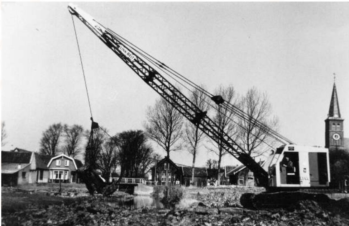
Afb. 75 Dies Zwagemaker met zijn dragline bezig met het afdammen van de Sluissloot. Op de achtergrond is de brug nog aanwezig in de Westerkerkweg. Deze vormde een historische grens in de gemeenschap Venhuizen.
