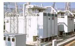
起動変圧器の例
