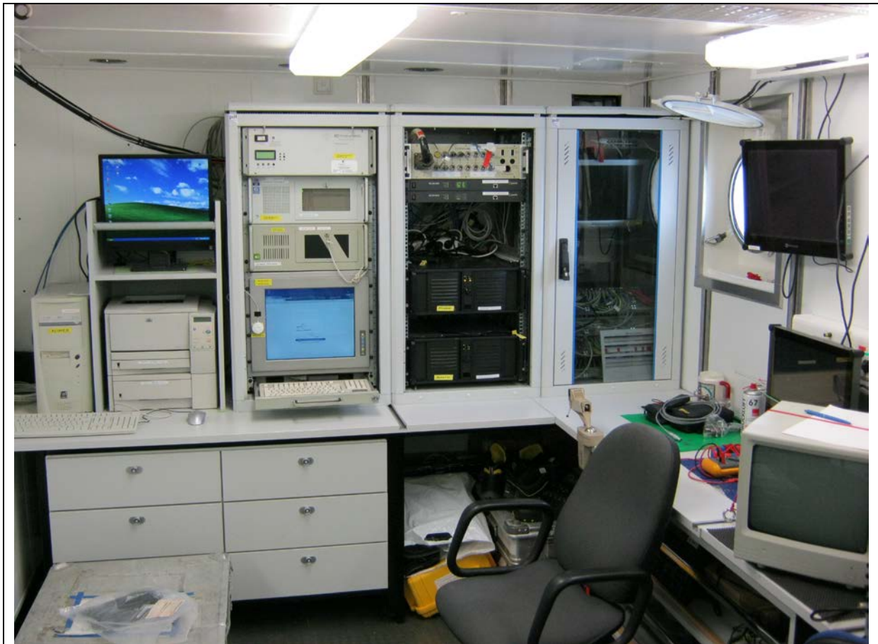
Abb. 10.5.4: Trockenlabor, Vorkante Stb., v. l. n. r.: (i) DHCP Server und e-mail Rechner ; darüber Dominator des Reiseassistenten des IOW; (ii) DShip , mit zentralem PC, zentraler Kontrollanzeige auf Bildschirm, Terminalserver für den Dateneingang, Terminalserver für die direkte Ausgabe von Datengruppen (Spiegelung, Rückseite des Gerätes mit Steckleiste sichtbar); (iii) digitale Kreiseltochteranzeige (rotes Display), darüber mit blauem Tastenfeld die Do-Log Anzeige; (iv) unter dem Bulleye Tochter der elektronischen Seekartenanzeige
