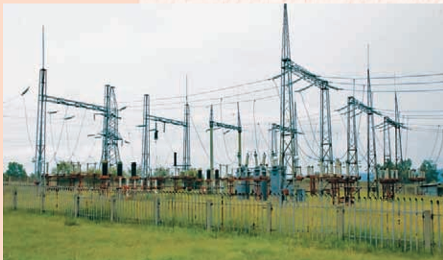
Подстанция береговой насосной станции № 1. 2006 г.
