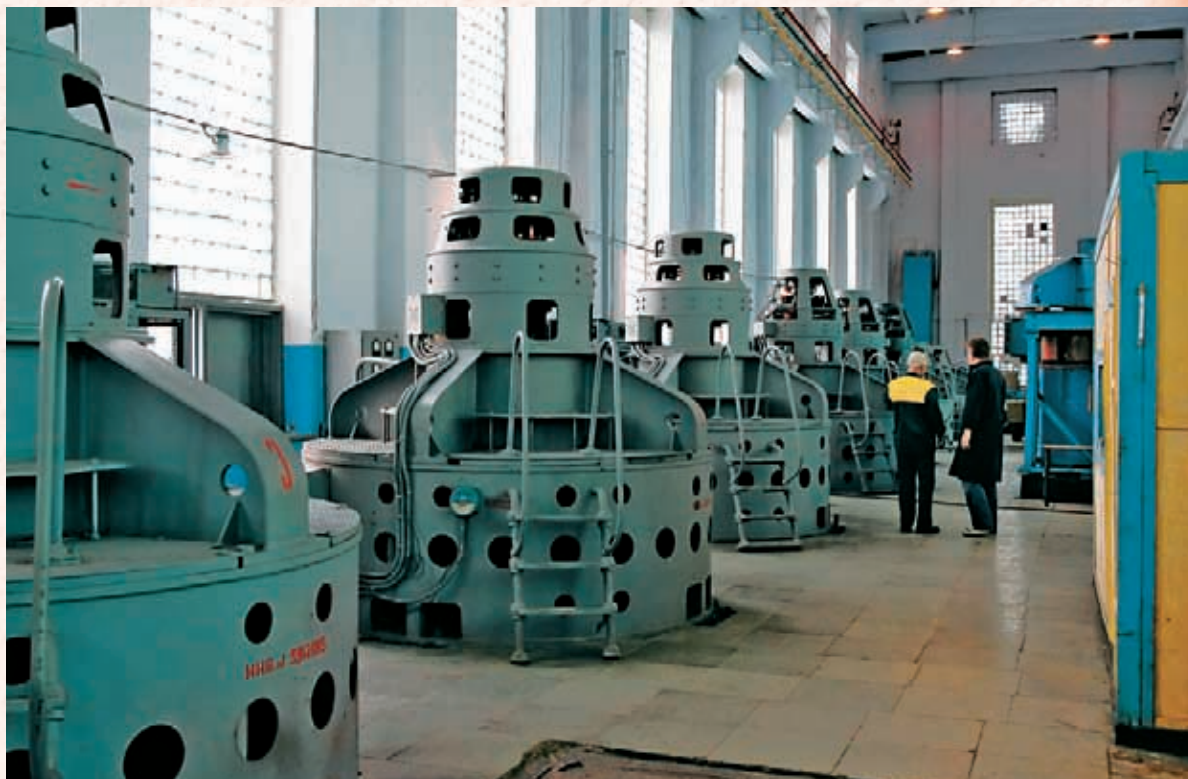
Насосная станция № 1, машинный зал. 2006 г.
