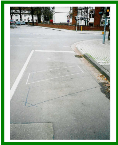
Bild 60a: In der Fahrbahn verlegte Anforderungsschleife zur Erfassung von Kfz und Radfahrern (BOSSERHOFF 2006)
