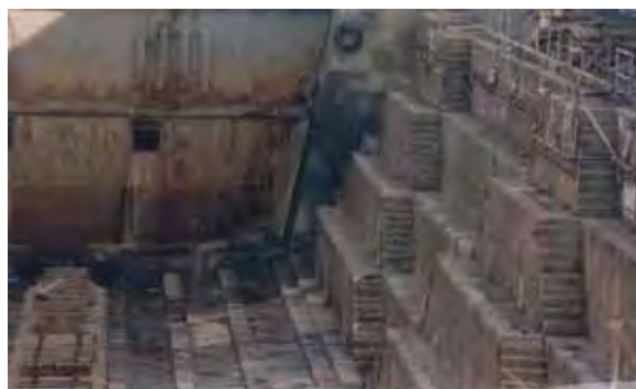
【旧住友重機械工業浦賀艦船工場 第1号ドック】 （神奈川県横須賀市）
