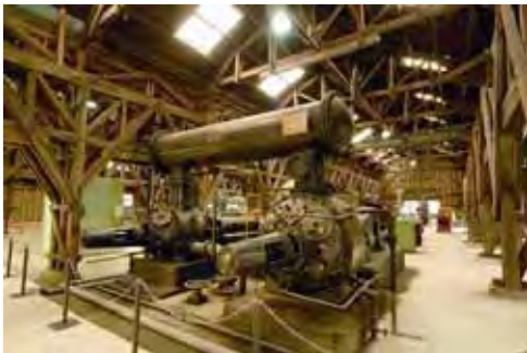
【大型コンプレッサー(日鉱記念館所蔵)】 (茨城県日立市)
