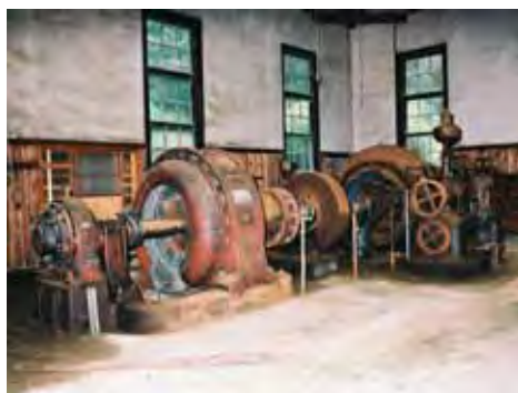
【佐渡鉱山 戸地川第二発電所(発電機)】 (新潟県佐渡市)
