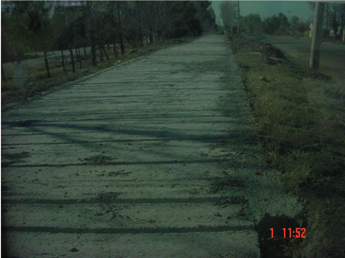
Tramo tapado de la Hijuela 3° Reynoso para evitar su uso por parte de los bañistas.
