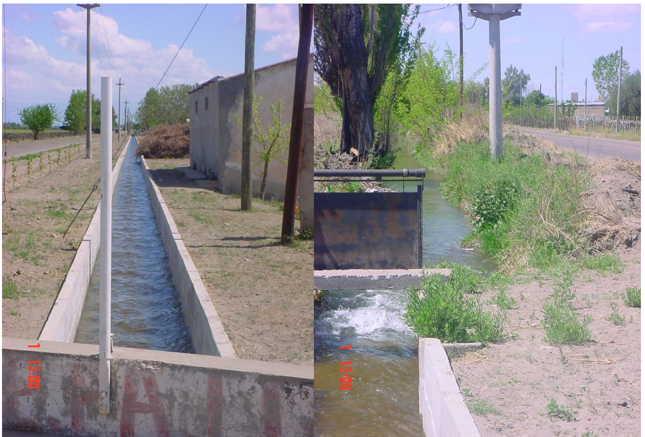
Vista de la 7° Hijuela Zapata al final de la etapa impermeabilizada-foto de la izquierda- y al inicio de la 2° etapa (sin impermeabilizar)-foto de la derecha-.
