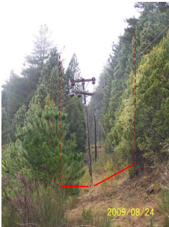
Imagen 2. Zona Cerro Radal Oeste, sobre línea eléctrica
