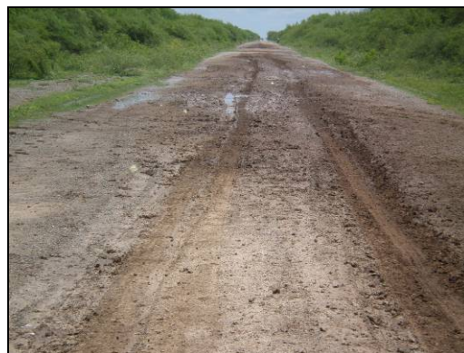
RIPIO AFECTADO POR LLUVIAS RECIENTES
