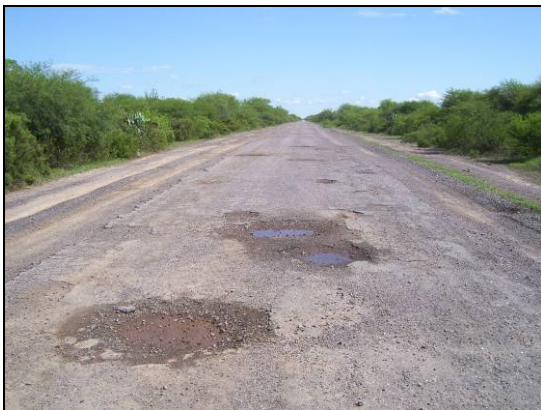
ESTADO DEL TRATAMIENTO ASFALTICO DEL TRAMO 1
