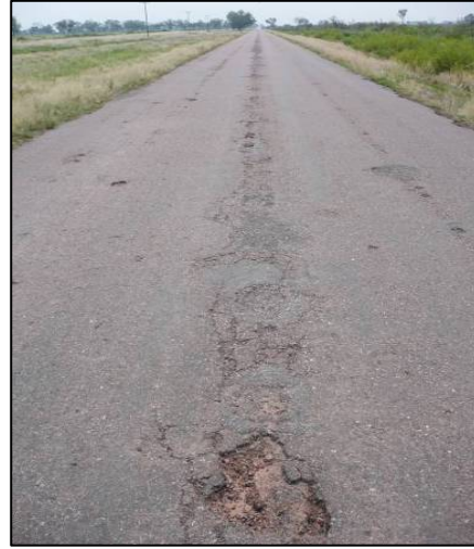
BACHES SOBRE EL EJE DE CALZADA
