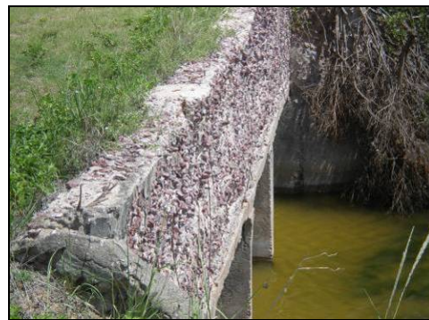
EFFECTO DE SALES SOBRE EL HORMIGÓN
