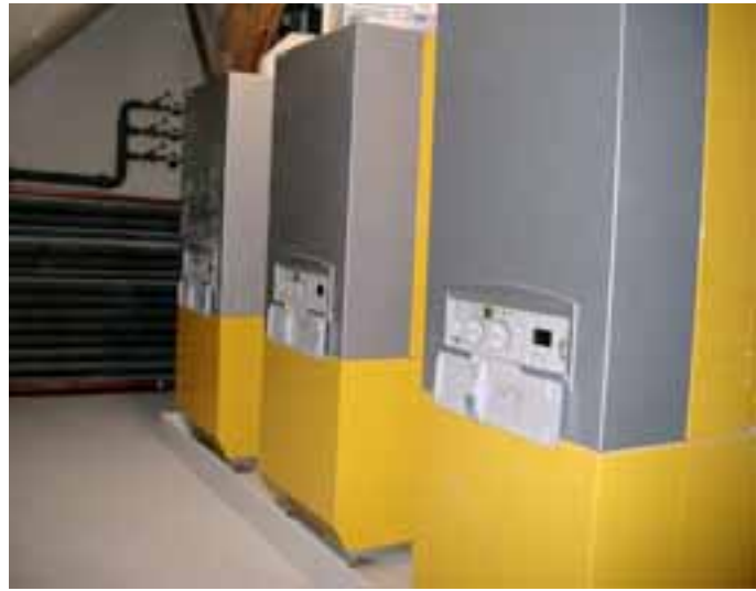
Brennwertkessel im Feld
