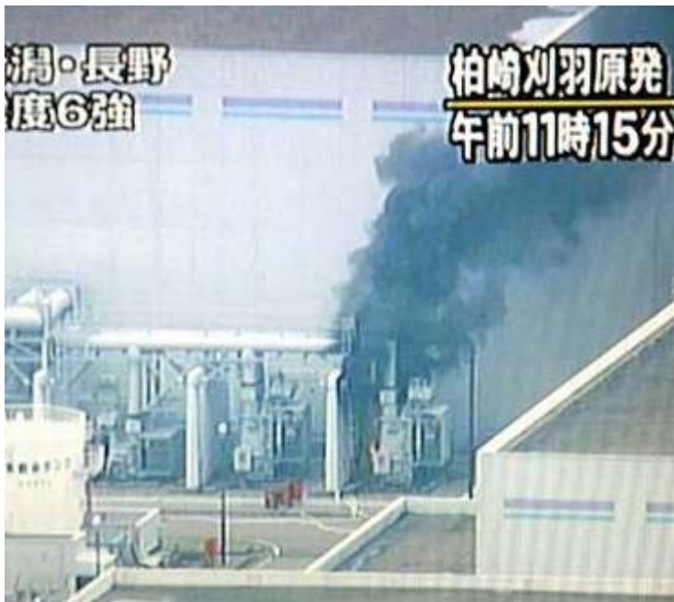
Incendie d'un des transformateurs du réacteur n°3. Où sont les pompiers ?
