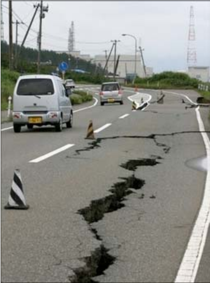
Derrière la route crevassée, la centrale de Kashiwazaki © AP
