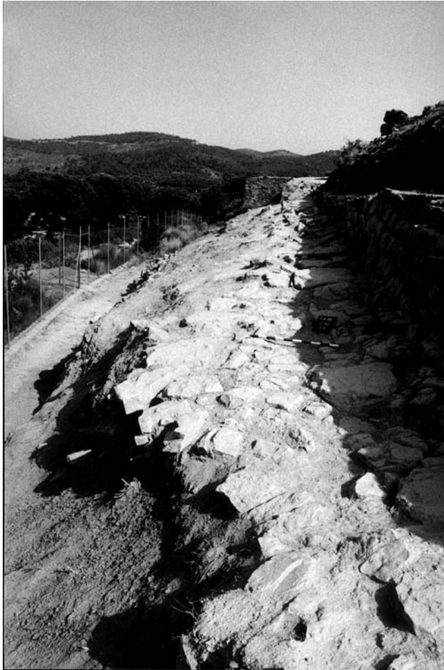
Fig. 6: Erosión de la calzada
