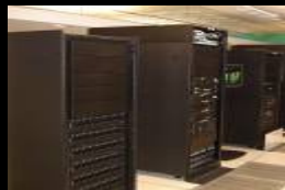
智慧的数据中心
