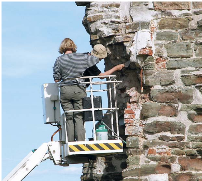
Skadeinventering med skylift. Foto: Henrik Lindblad.
