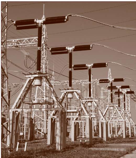
Элегазовые выключатели на ПС «Уфимская-500»
