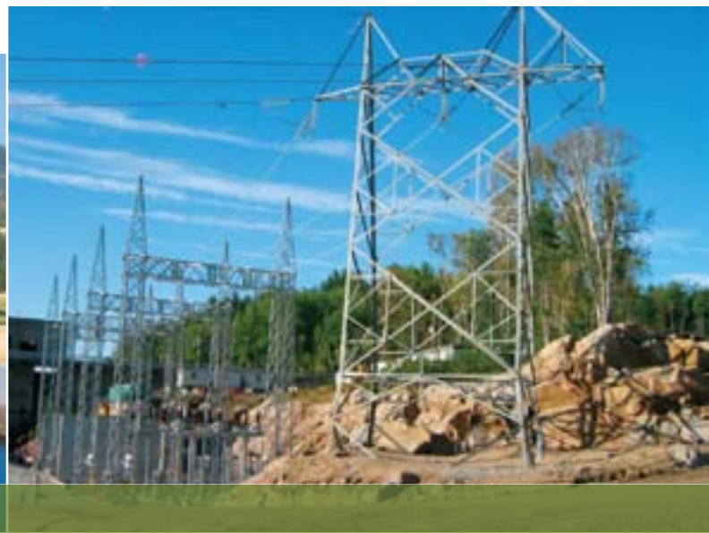
Un poste et une ligne à 69 kV relient au réseau la centrale Mercier.
