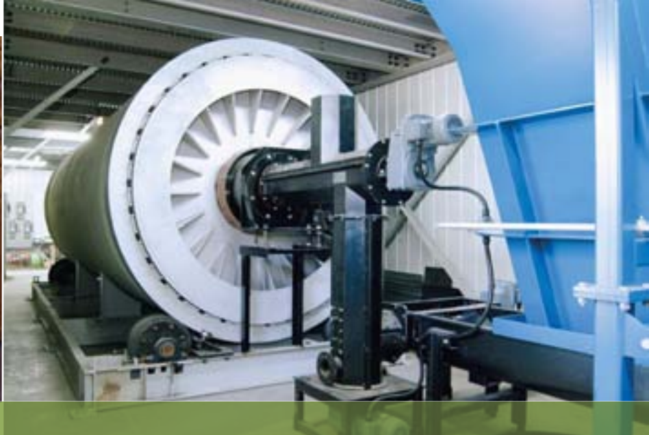
Développé par le Laboratoire des technologies de l'énergie, un four rotatif équipé d'une torche à plasma servant à assécher les boues biologiques a été installé à l'usine d'épuration de Valleyfield.
