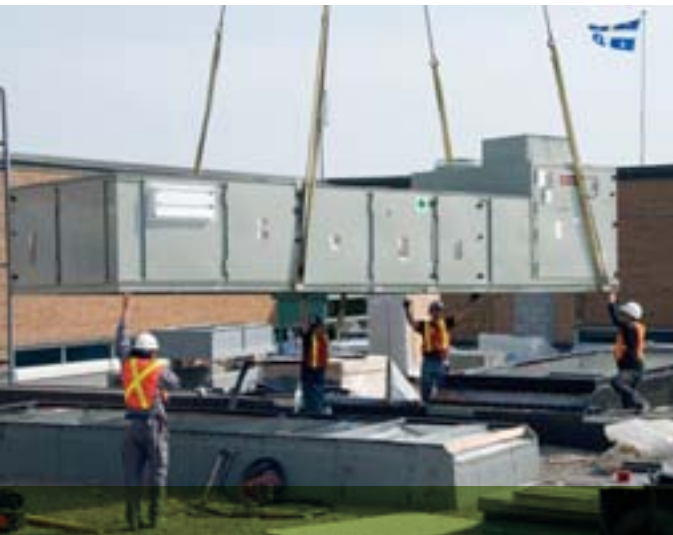
Installation d'un système de ventilation éconergétique au bâtiment administratif de la rue Jarry, à Montréal.
