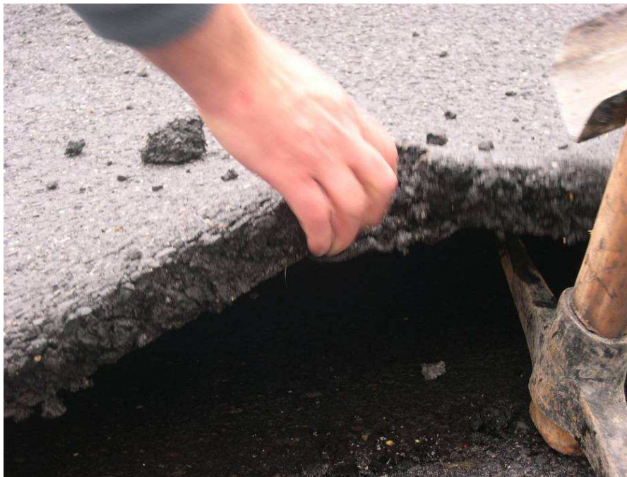
1.1. kép: Extrém példa, amikor az aszfaltrács beépítése miatt ennyire nincs együttdolgozás a rétegek között
