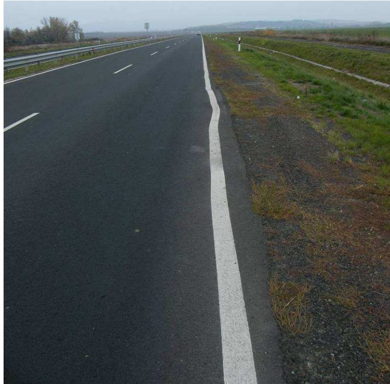
A textília beépítés hatására a kopóréteg megsűszott, és a keréknyomvályú ezért alakult ki a felújított főúton.
