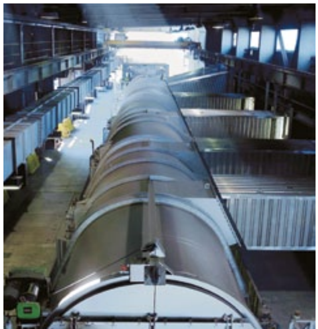
Waste-gas recirculation hood
