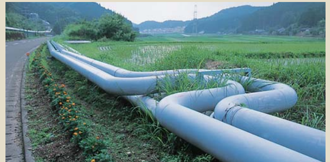
▲菱刈鉱山から温泉街へ続く給湯パイプライン
