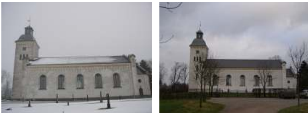
T. v: Trollenäs kyrka från söder före renoveringen med nedsmutsade fasader och vittrande färgskikt. T. h: Trollenäs kyrka från söder efter restaureringen med fasader avfärgade med CD-färg.
