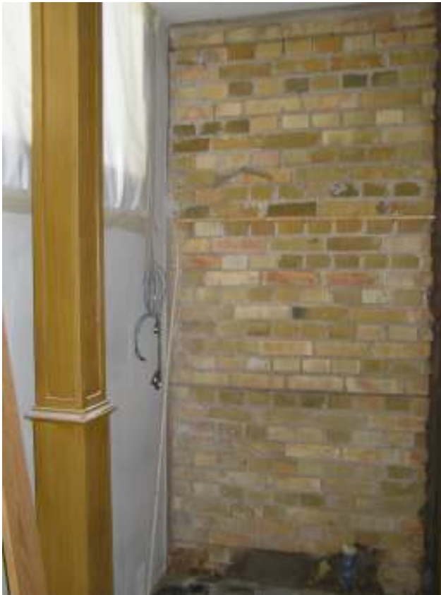
Efter demontering av panelen på väggen under läktarens sydvästra sida framkom tegelväggen som uppfördes under restaureringen 1969.
