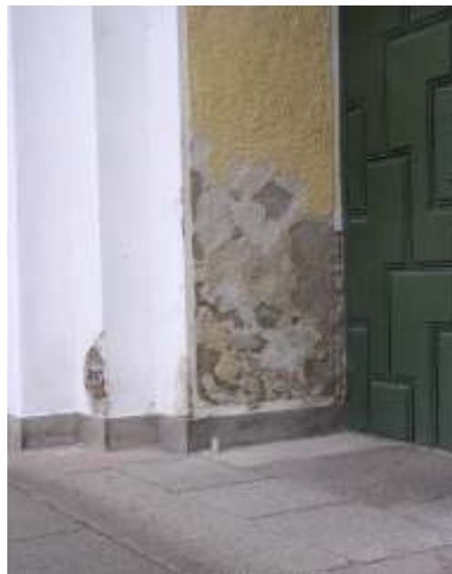
Västportalens norra sida med skador orsakade av inträngande vatten med frostsprängning som följd
