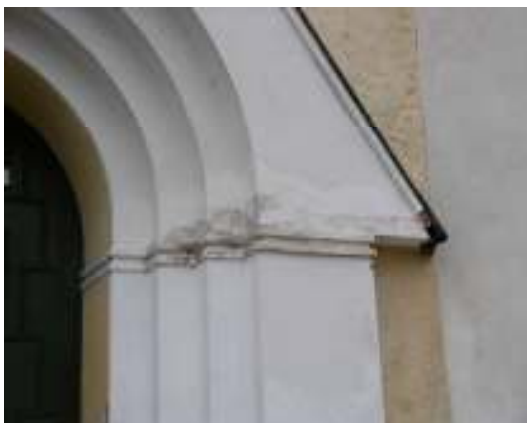
Skador i västportalens kapitälband pga rostande järn.
