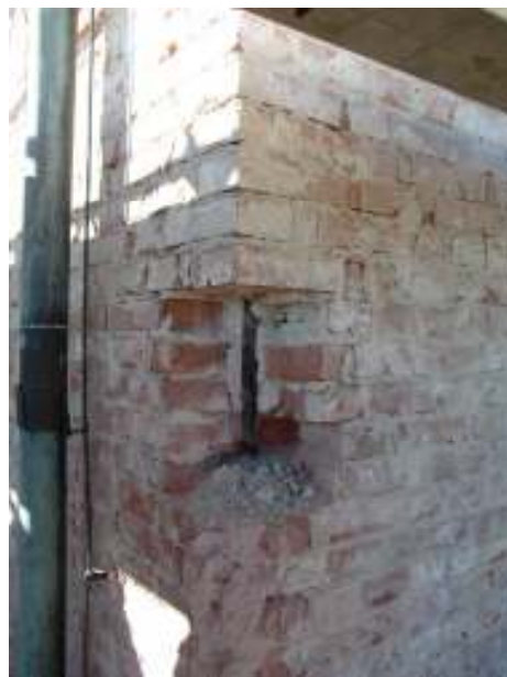
Sprickan på bilden till vänster berodde på korrosion i ett inmurat järn. Järnet rengjordes, rostskyddsmålades och täcktes med papp innan det murades in igen. Hörnet nätades före putsning.
