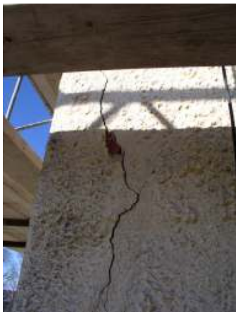
Spricka i putsen i övre delen av tornets sydöstra hörn.
