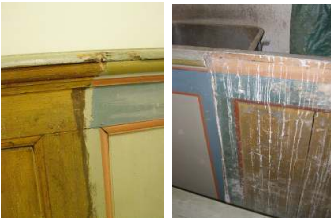
Bild t.v.: På baksidan av en av bänkinredningens skärmar återfanns en av de två ådringsmålningar som kyrkans inredning tidigare haft. Bild t.h.: På baksidan av en annan av skärmarna återfanns en ännu äldre färgsättning, troligen från 1800-talets första årtionden, med kraftigt rött listverk, ockragula speglar och blågrönt ramverk. Det är denna färgsättning som låg till grund för 1957 års färgsättning av bänkinredningen.
