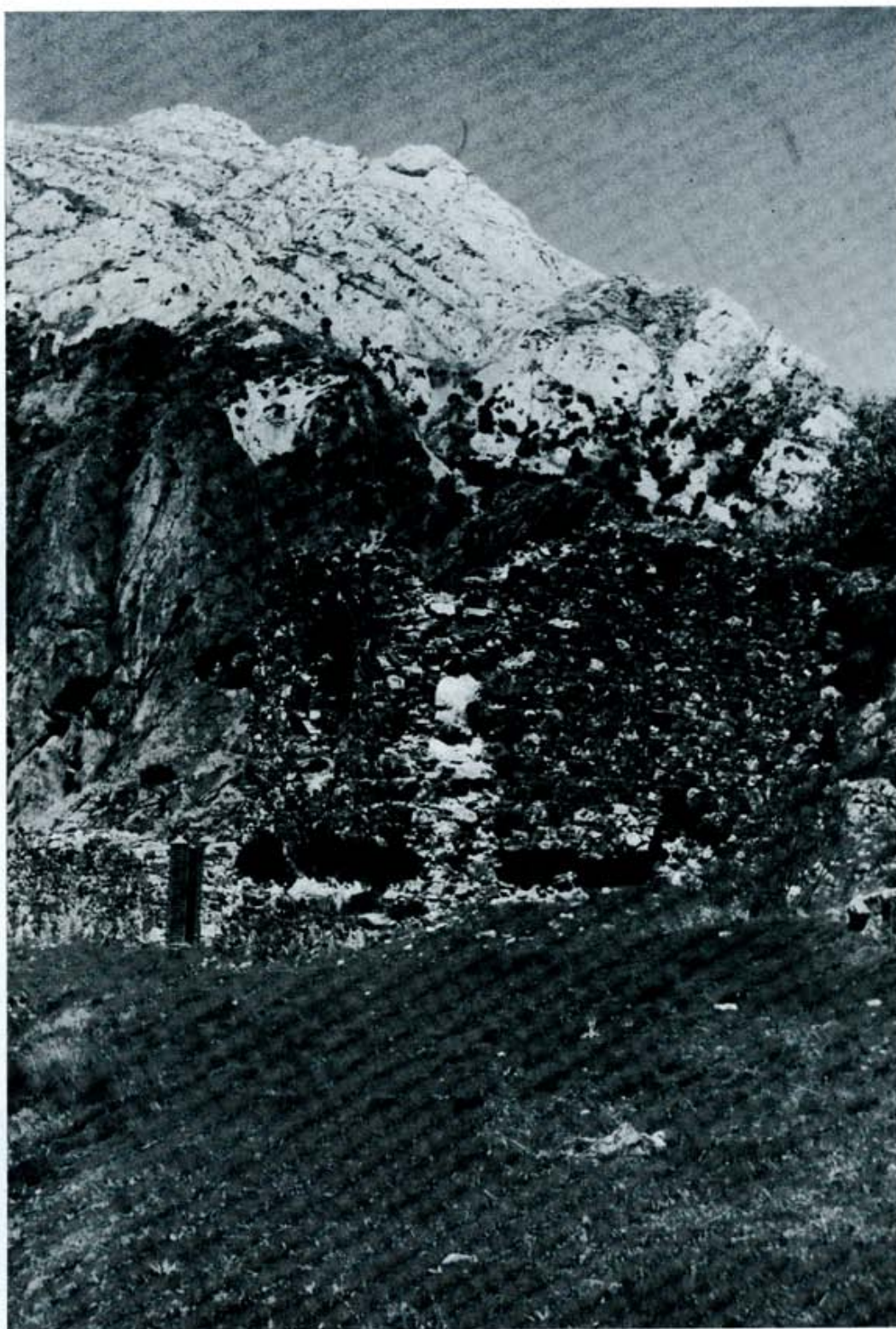
Castillo de Montuerto. Exterior del ábside de la iglesia, con vanos y esquinas expoliados de sus sillares
