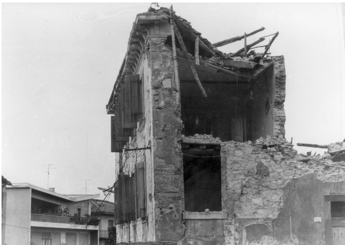
Tipične poškodbe pri VIII. stopnji EMS lestvice. Delne porušitve zgradb (zelo težke poškodbe na nekonstrukcijskih elementih) v Breginju.
