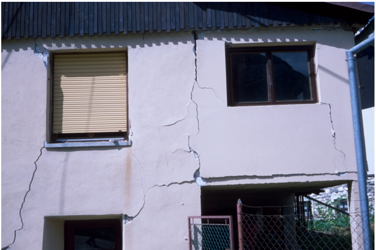
Močno poškodovana zgradba v Čezsoči kaže neprimerno dozidavo prizidka
