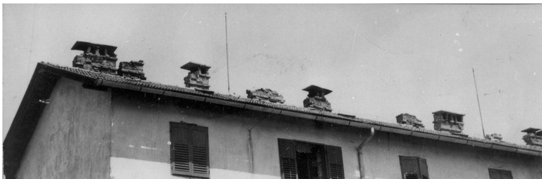
Poškodovani dimniki v Litiji.
