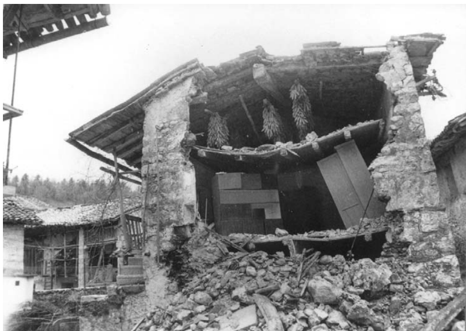
Poškodovan objekt v Breginju.
