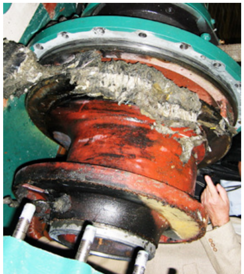
Abb. 2 Verstopfter Radseitenraum einer Abwasserpumpe
