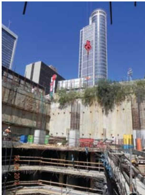
החפיר עם קירות הסלארי של מגדל "אמות אטריום" כשמעליו מתנשא מגדל "אביב", הגובה במגדלי המזרח התיכון. בצילום נראים חלק מהעמודים הקבועים של מגדל "אמות אטריום" היצוקים מלמטה למעלה
