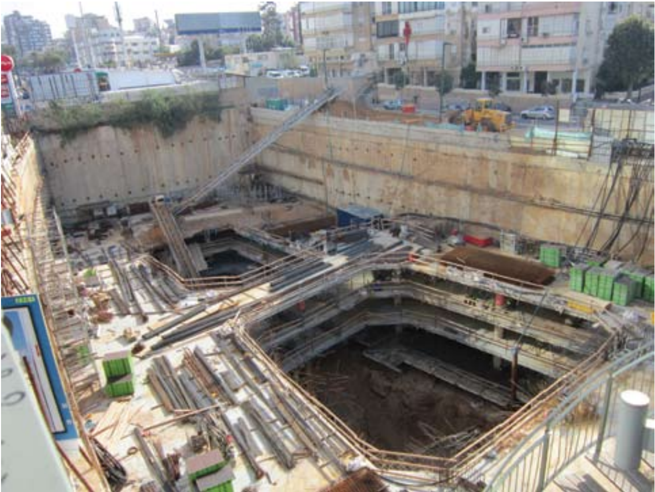
התקרות של חניוני המגדל התומכות בקירות הסלארי בדפנות במקום העוגנים. הטבעות במרכז נועדו לגרעיני המגדל כשבבור השמאלי נראה המסוע להוצאת העפר מהחפירה ובבור הימני נראה הצינור דרכו נשאבים מי התהום מבור שנחפרה באתר
