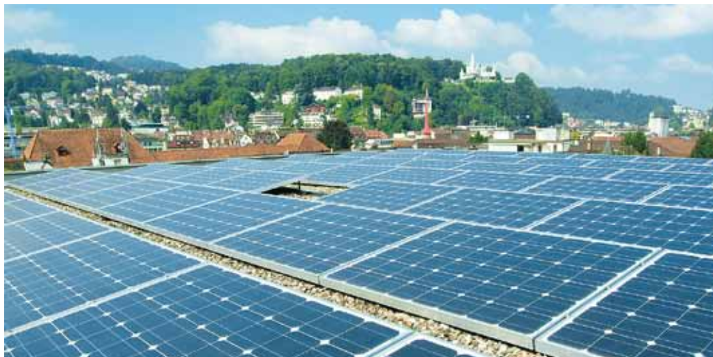
LUKB-Hauptsitz: 220 Quadratmeter Solarpanels für jährlich rund 25 000 kWh Luzerner Solarstrom.
