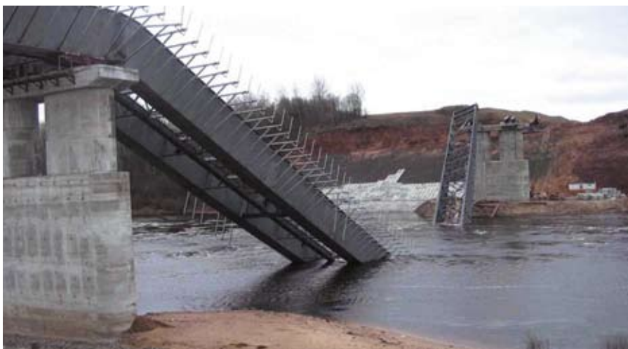
Рис. 3. Обрушение строящегося моста через реку Западную Двину на юго-западном обходе Витебска. После окончания рабочей смены произошла самопроизвольная деформация конструктивного элемента металлического пролетного строения
