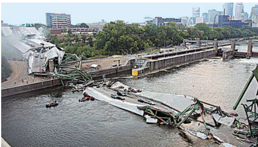
Рис. 4. Обрушение моста в Миннеаполисе (США)
