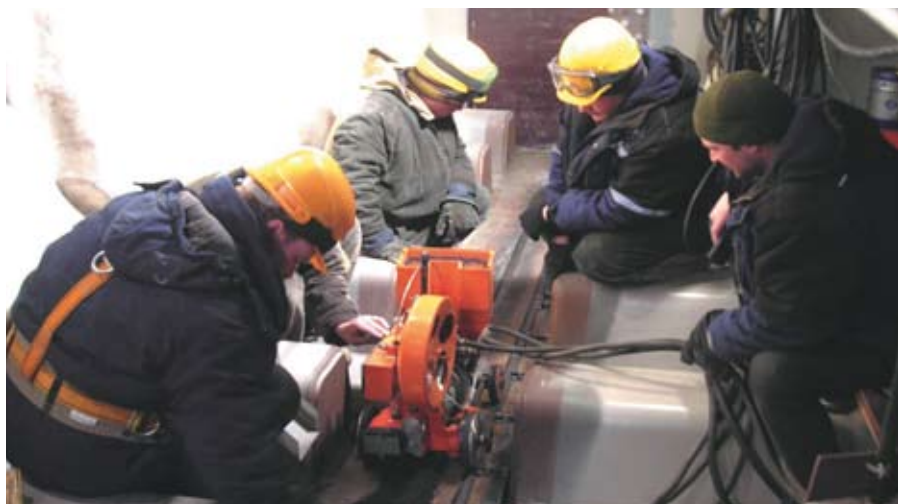
Рис. 7. Автоматическая сварка под флюсом монтажных панелей в створе мостового перехода на о. Русский через пролив Босфор Восточный
