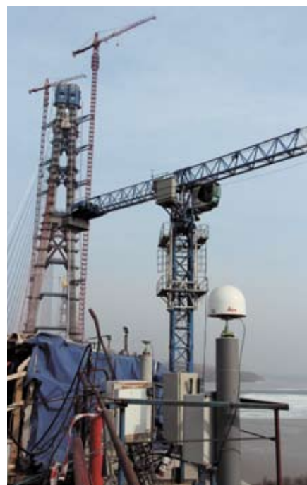
Рис. 3. Базовая станция на опоре М12
