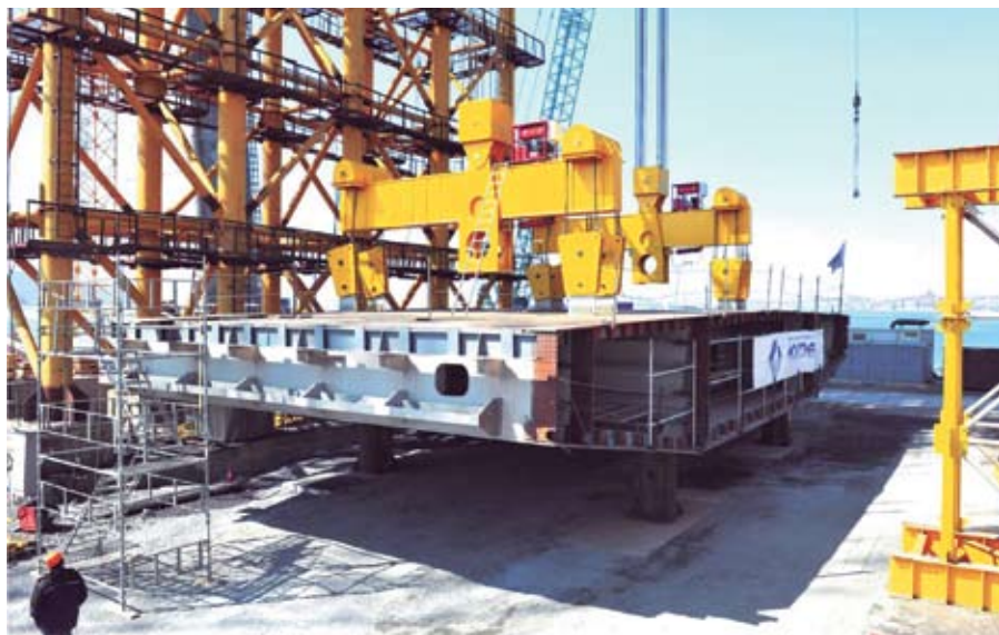
Рис. 6. Монтаж панелей мостового перехода на о. Русский через пролив Босфор Восточный в г. Владивостоке
