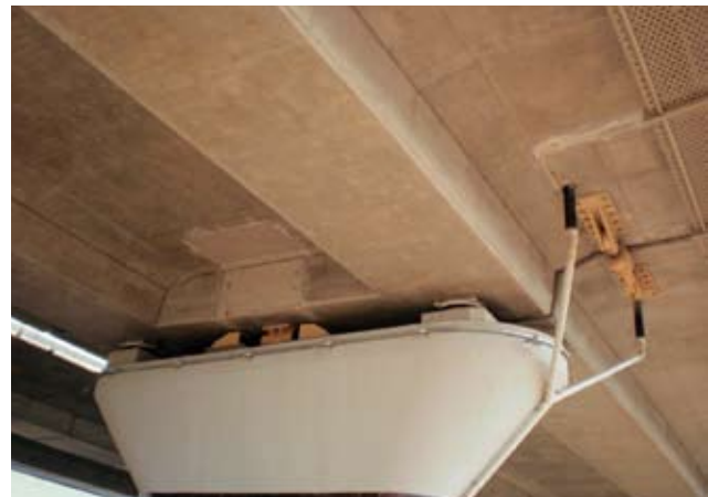
Рис. 4. Поперечный демпфер между пролетным строением и опорой, шок-трансмиттер между пролетными строениями
