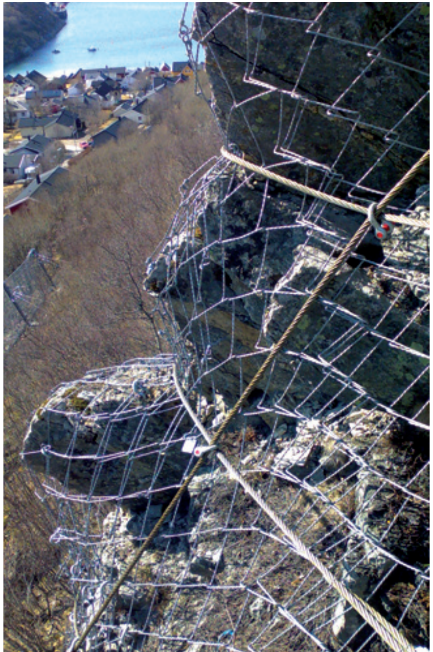
Rassikring i Kvalvik.
