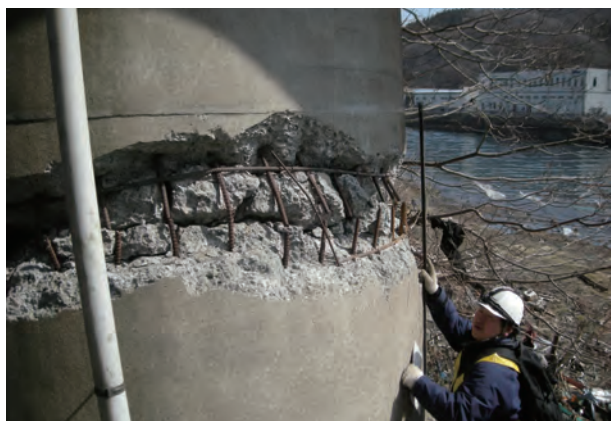
写真 2.3.6 (2) 亀裂が入った大渡川橋梁橋脚
