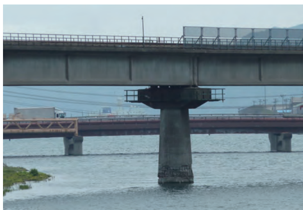
写真 2.3.6 (1) 亀裂が入った大渡川橋梁橋脚
