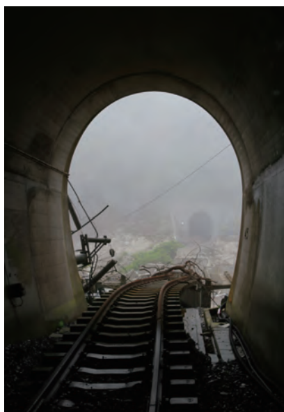
写真 2.3.3 流出したコイコロベ沢橋梁
