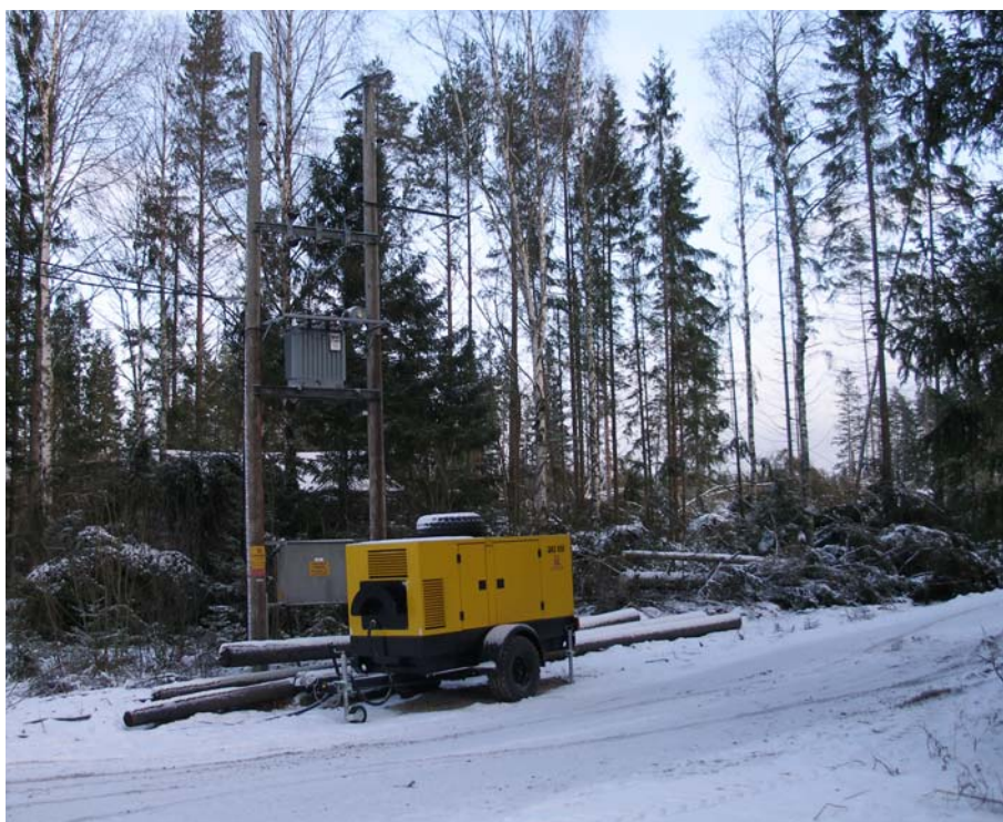
Figur 13. Socialstyrelsens reservkraftverk, ca 100 kVA, inkopplad i en nätstation (stolptransformator) i Lessebo kommun vid Gudrun. Foto: Christer Langner, C L J Utveckling AB.
