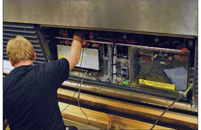
Feilsøking på nettstrømretter. Foto: Espen Hagen.
