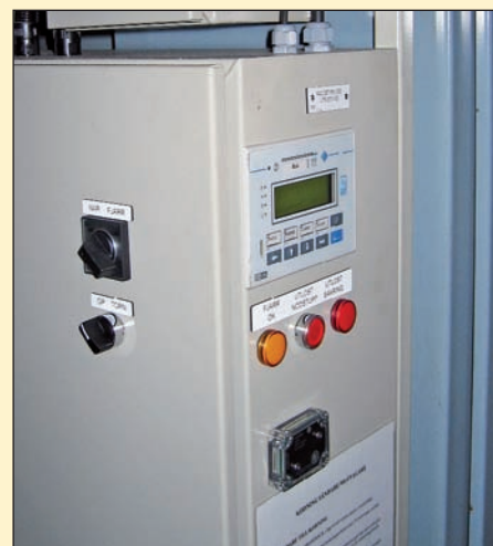
Nytt skap for radiostyring i maskinrommet på Rc4. (Foto: Mads Skoland)
