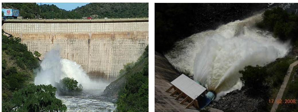
Figura 6.5: Vista de la descarga y de las válvulas de descarga de la toma de riego (2008).
