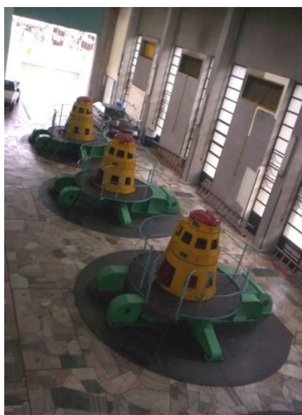
Figura 6.27: Sala de máquina en actividad
