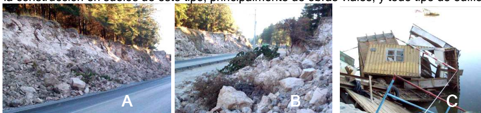
Fig. 5.2.1; A - B; Imágenes de los escarpes producidos por los movimientos de ladera en el sector del Lago Rapel. C; Caseta colapsada por subsidencia y o licuefacción del suelo, en el Lago Rapel.
