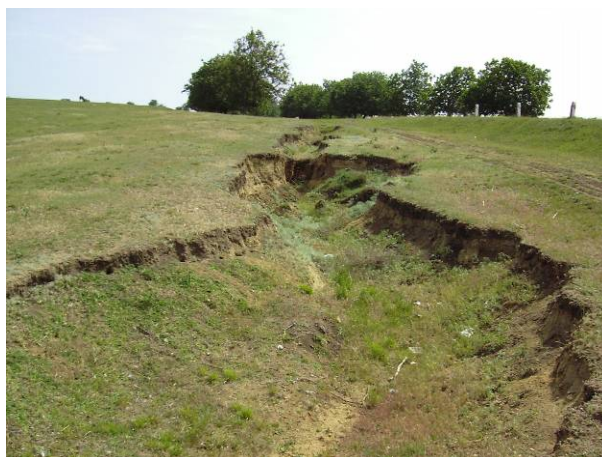
Efectele degradării pantelor
