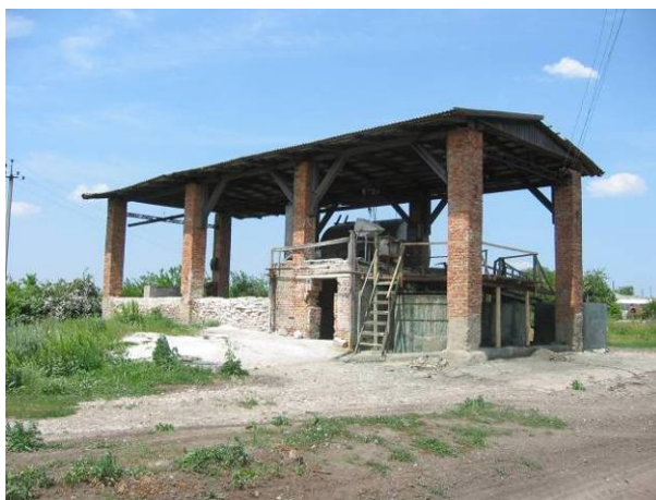
Stațiunea de pregătire a soluțiilor pentru protecția plantelor din s. Taraclia, r-nul Căușenii
