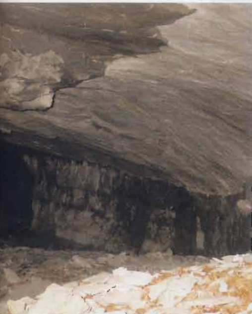
Sulle pareti delle gallerie sono evidenti i vari strati appartenenti alle passate ere geologiche. Inoltre, se si osserva la volta, si vede molto bene un recente crollo di materiale. (Foto C. Iacovone)
