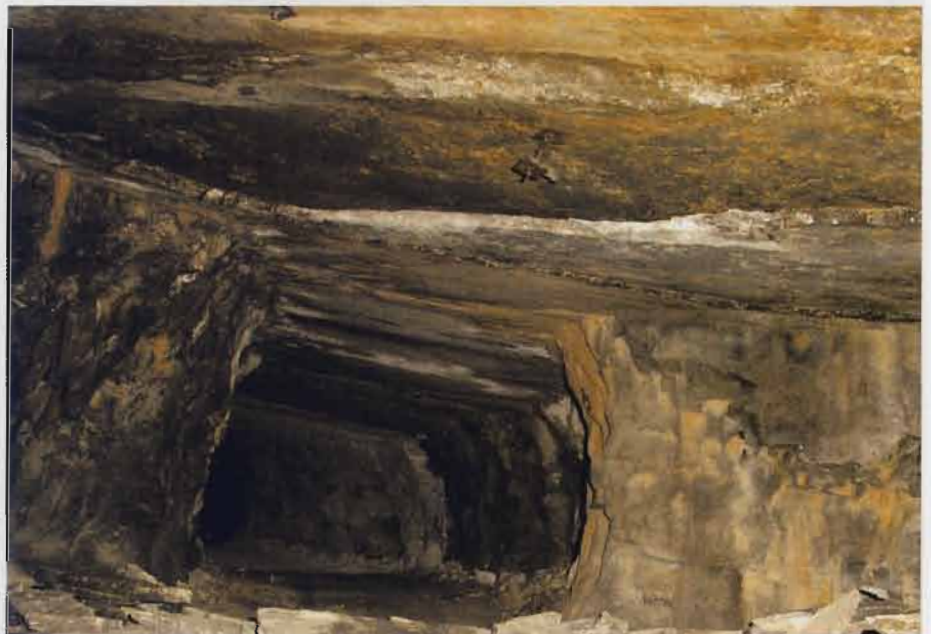
Per evitare improvvisi crolli, le parti più pericolose come le volte, erano tamponate con placche di ferro. (Foto C. Iacovone)
