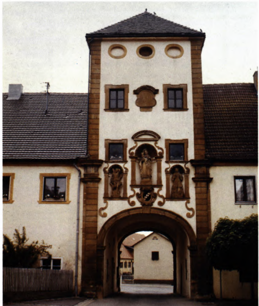
TORTURM des ehem. Klosters Kirchheim/Ries, Ostalbkr. Der prachtvolle Figureschmuck ist für den privaten Besitzer eine zusätzliche Last; ein Fall für die Denkmalstiftung.
