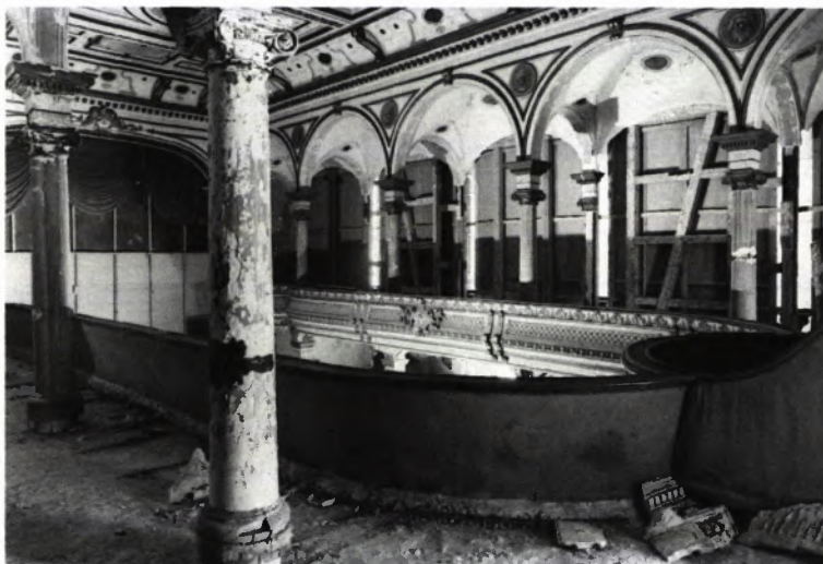
18 DER 1. RANG. Im Vordergrund rechts herabgefallene Stuckteile. Die Medaillons in den Bogenzwickeln sind in Öl auf Leinwand gemalt.
