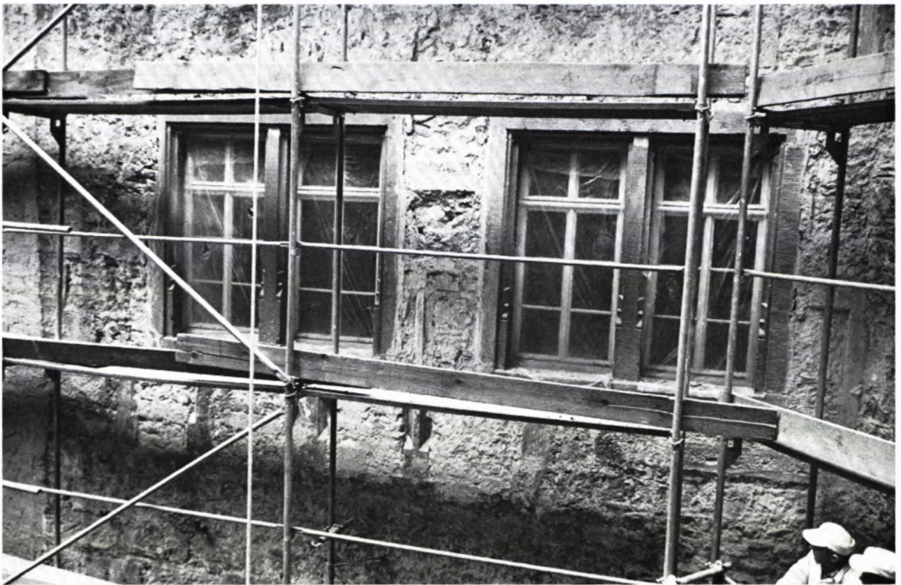
GOTISCHE DURCHFENSTERUNG DES OSTWÄRTIGEN GEBÄUDEFLÜGELS. Nach dem Abschlagen des alten Wandputzes traten hier die in die Wand einbezogenen Überreste (Sohlbänke, Profilstäbe, Fensterstürze) einer älteren Fenstergliederung zutage. Gotisch wie die heutige, der 2. Hälfte des 16. Jahrhunderts zugehörige, scheint sie von dem nach 1404 erfolgten Wiederaufbau der Burg herzustammen. Die Lage der alten Fensterrahmen deutet darauf hin, daß die Innenräume dieses Baues ursprünglich niedriger gehalten waren. Ein Brand, dessen Spur anderweitig festzustellen war, mag im 16. Jahrhundert Anlaß geworden sein, die neu einzubauenden Räumlichkeiten höher auszuliegen, was eine andere, die jetzige Durchfensterung notwendig machte.
