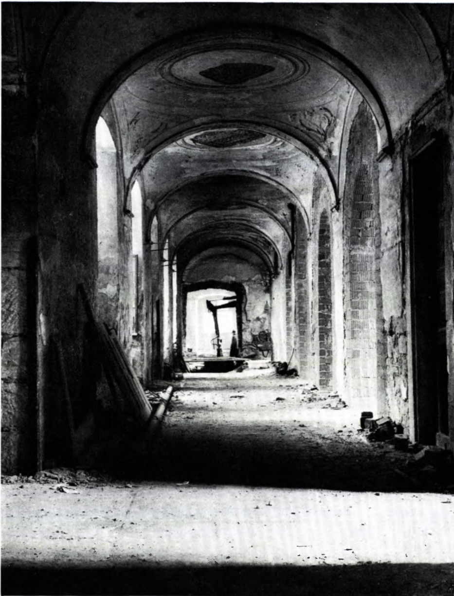
DER KREUZGANG IM PREDIGER. Obwohl die Hand der Bauleute hier teilweise schon tätig war, zeigt unser Bild recht eindrucksvoll den jammervollen Zustand, der den Prediger in fast allen seinen Teilen am Beginn der Erneuerungsarbeiten (1969) auszeichnete. Putz und Stuck waren zerrissen, verdreckt, die dezenten Farben in den Gewölben lieblos überstrichen. Untergangsstimmung überall, die das anfängliche Zweifeln an der Erhaltungsabsicht und ihrem kostspieligen Erfolg begreifbar macht.
