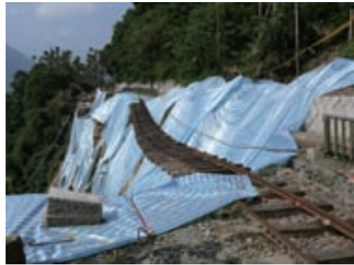
● 樟腦寮段崩塌，路基滑落山谷，僅剩鐵軌吊掛於半空中。
