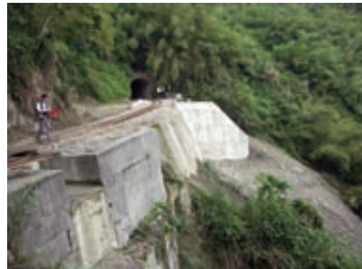
● 43k+800m處崩塌地現況，僅於路基處設有保護工程。
