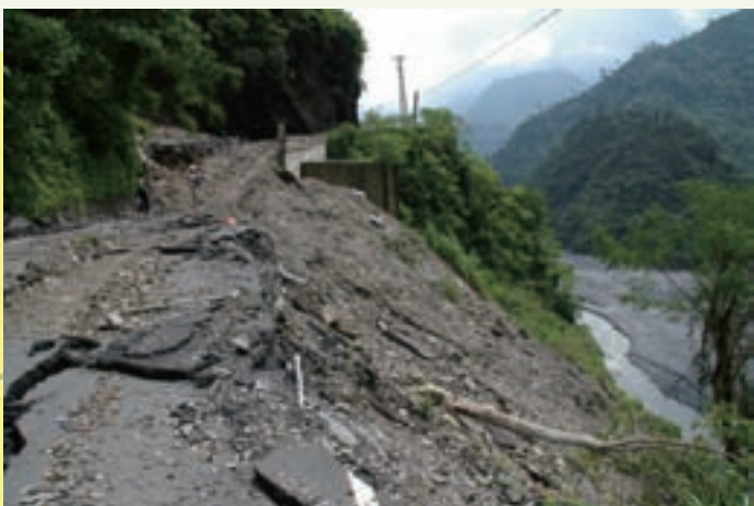
● 96年聖帕颱風造成好茶道路沿線有坍方與岩屑堆積，阻礙交通。
