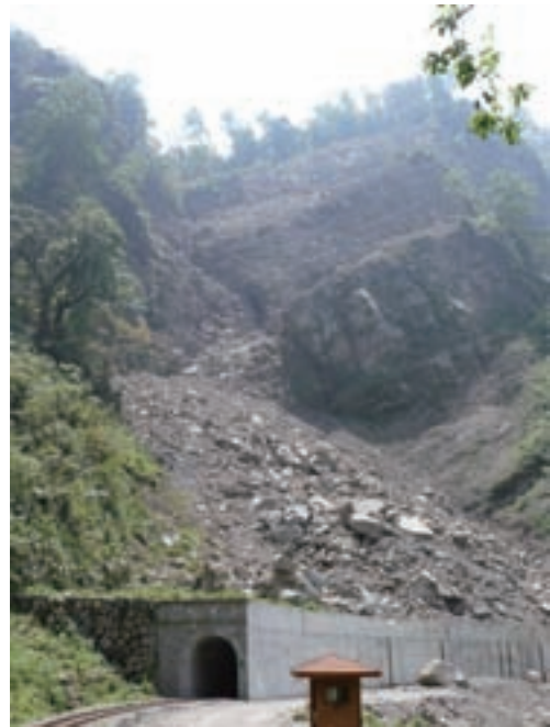
● 42號隧道口崩塌全貌。
