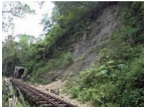
● 45號隧道口邊坡高約10公尺，坡面裸露，隨時可能有落石發生。
