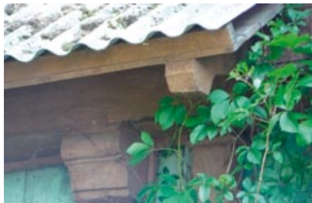
Zacios wklęsło - wypukły belek stropowych domu w Myszewu.
