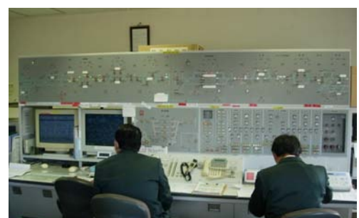
写真 1-1 井原コントロールセンターの統合制御盤
