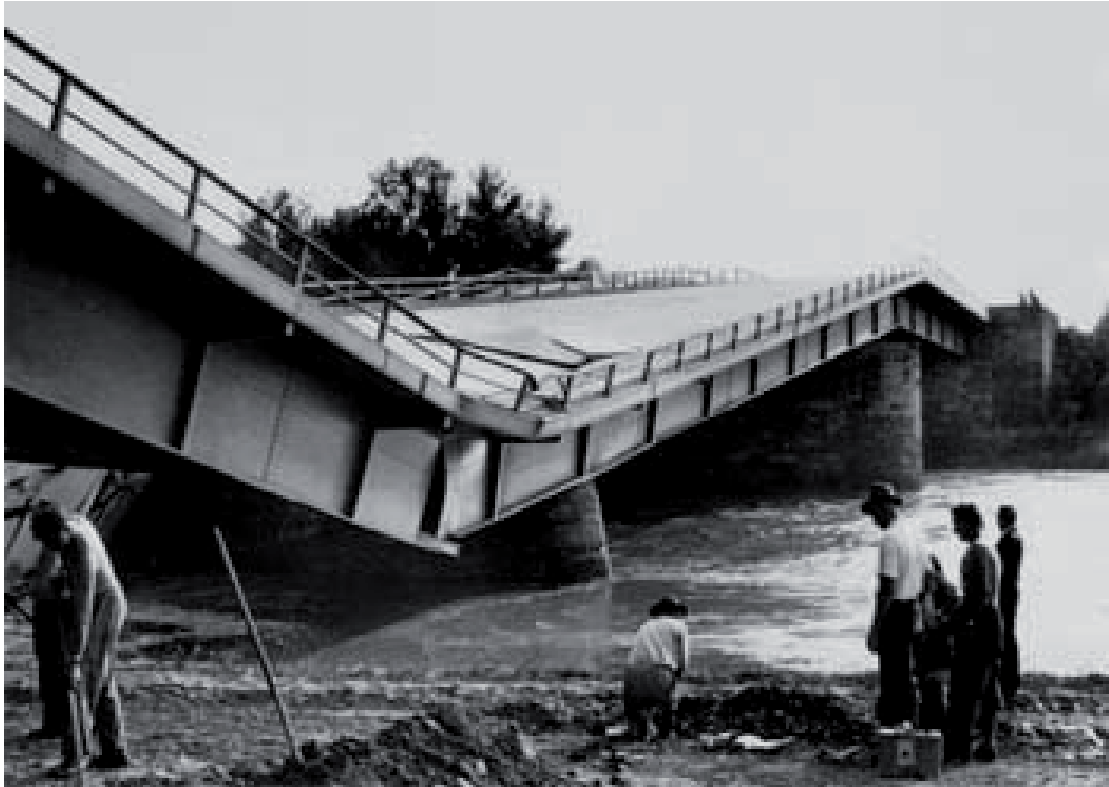
Abb. 4: Autobahnbrücke Lieferung nach dem Hochwasser 1959 (Quelle: WRS, 2000a).
