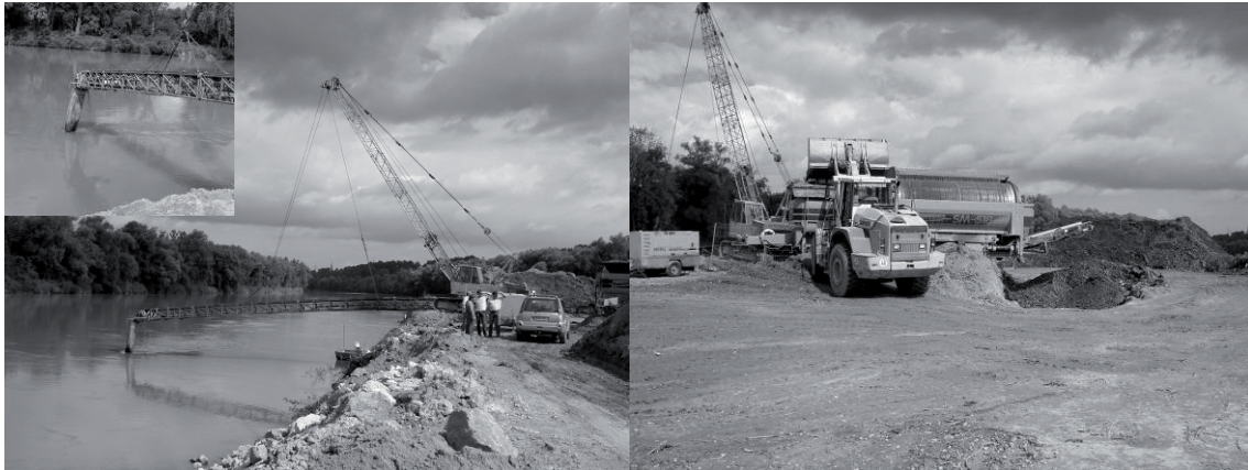
Abb. 2: Sandrückführung und Aufbereitung mit Trommelsieb.
