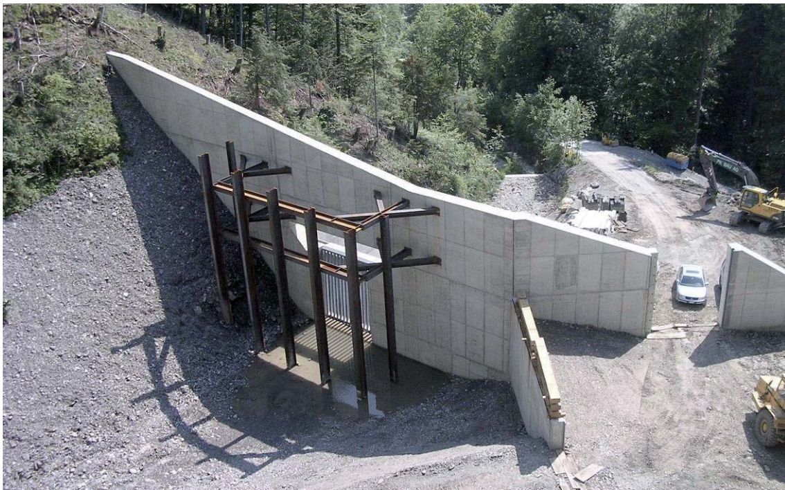
Abb. 3: Blick in Fliessrichtung aus dem Rückhalteraum auf das Abschlussbauwerk des Sammlers am Humligenbach mit rechtsseitigem Überlauf. Aufnahme kurz vor der Fertigstellung Ende Juli 2005 (Foto: PK Bau AG).
