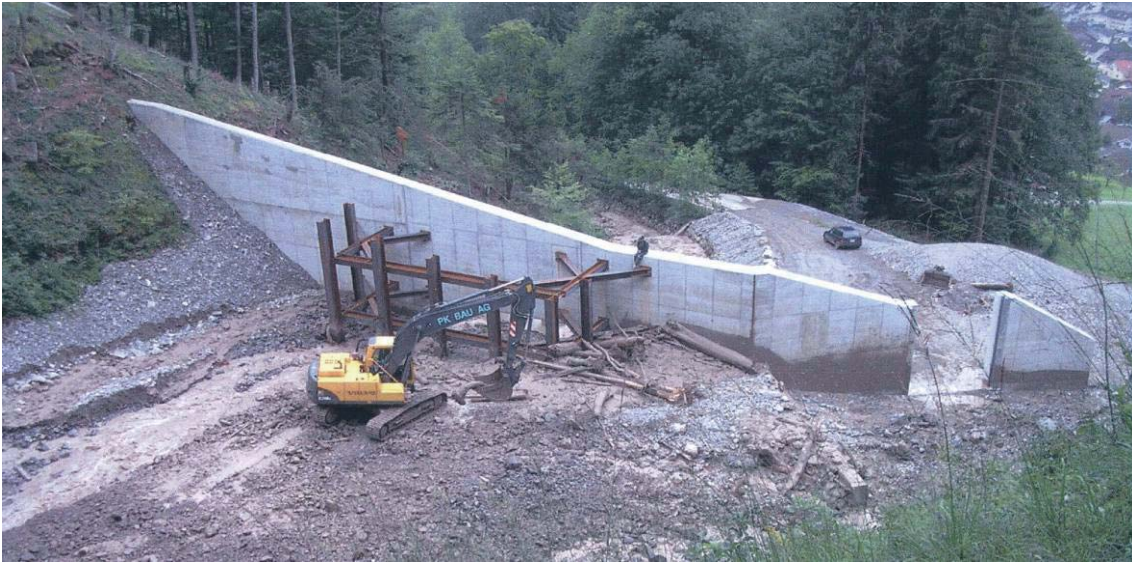
Abb. 4: Situation unmittelbar nach dem Ereignis vom August 2005 (Foto: PK Bau AG).
