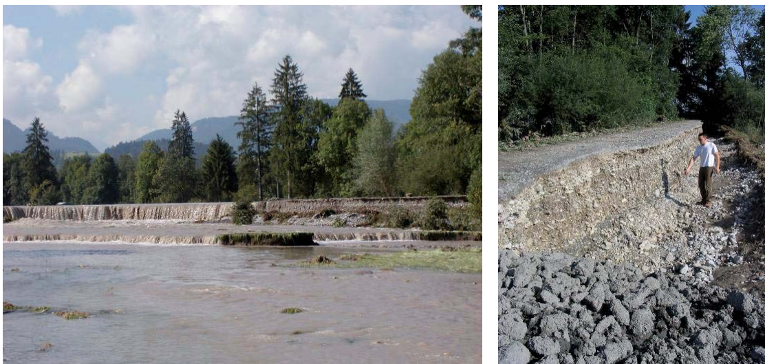
Abb. 2: überströmter Deich mit Innendichtung bei Fischen/Allgäu beim HW 2005.
